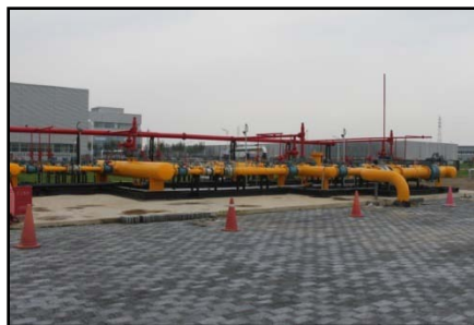
城市燃气门站
