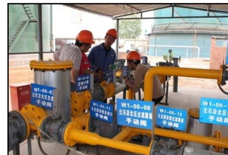
城市燃气中高压站
