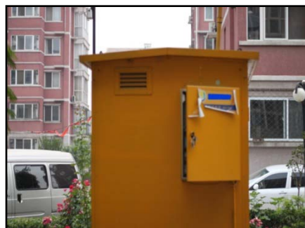
中低压调压站
