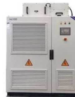
1MW储能系统逆变器
